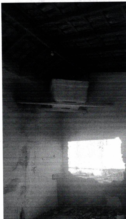
FOTO 16 – INSTALAÇÃO HIDRAÚLICA FORA DAS NORMAS – EM 19/07/2022.
