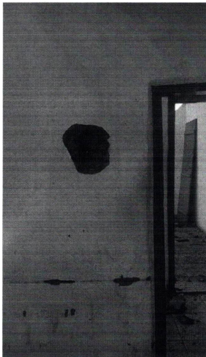
FOTO 34 – PAREDES DANIFICADAS – EM 19/07/2022.
