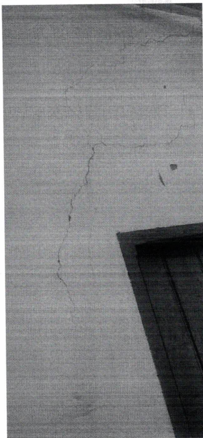
FOTO 32 – PROBLEMAS ESTRUTURAIS – EM 19/07/2022.
