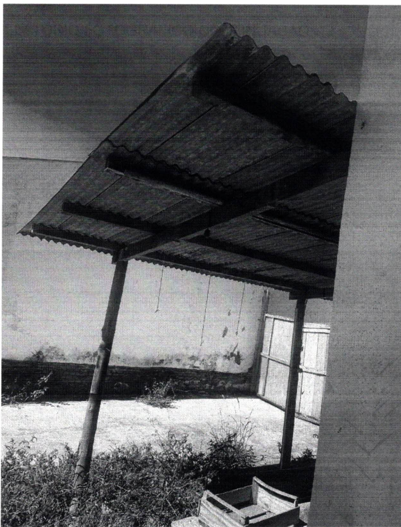
FOTO 10 – PILARES DANIFICADOS – EM 19/07/2022.
