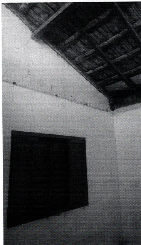
FOTO 28 – JANELAS DANIFICADAS – EM 19/07/2022.
