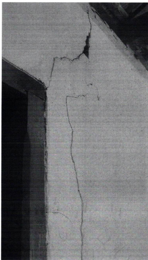
FOTO 42 – PROBLEMAS ESTRUTURAIS – EM 19/07/2022.
