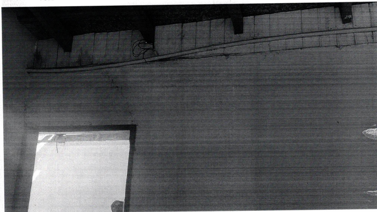
FOTO 23 – INSTALAÇÃO HIDRAÚLICA FORA DAS NORMAS – EM 19/07/2022.
