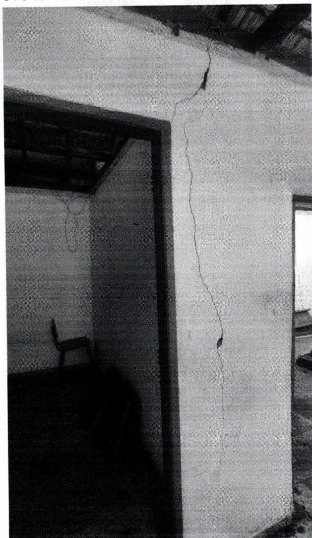
FOTO 36 – PROBLEMAS ESTRUTURAIS – EM 19/07/2022.
