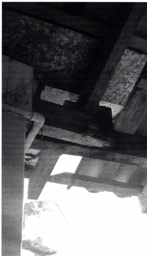
FOTO 50 – TELHADO DANIFICADO – EM 19/07/2022.
