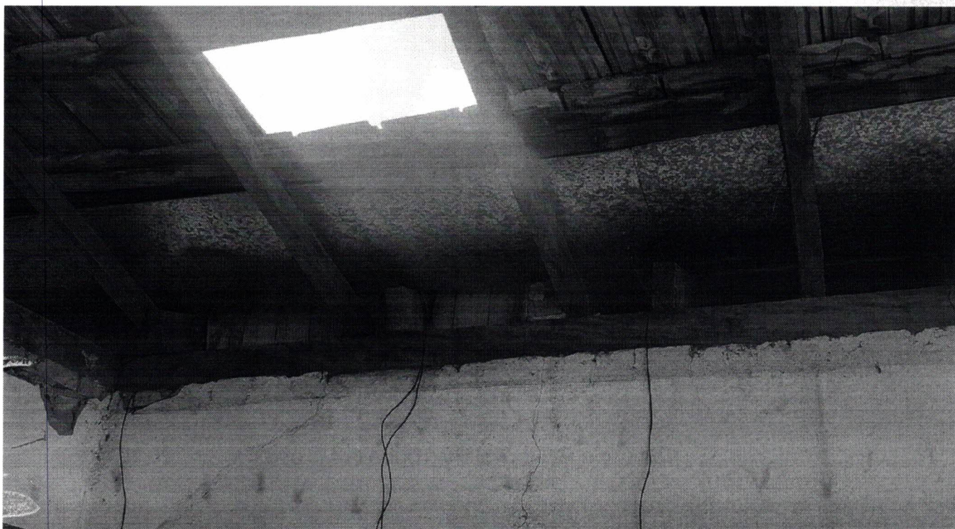
FOTO 18 – TELHADO DANIFICADO – EM 19/07/2022.
