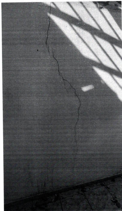
FOTO 39 – PROBLEMAS ESTRUTURAIS E TELHADO DANIFICADO – EM 19/07/2022.
