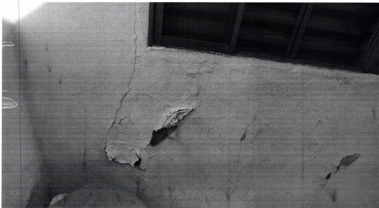
FOTO 46 – PROBLEMAS ESTRUTURAIS – EM 19/07/2022.
