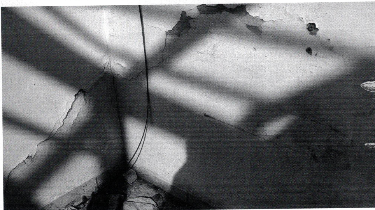
FOTO 43 – INFILTRAÇÕES E REBOCO DANIFICADO – EM 19/07/2022.
