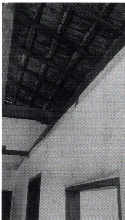
FOTO 30 – TELHADO COM MADEIRAMENTO DANIFICADO – EM 19/07/2022.
