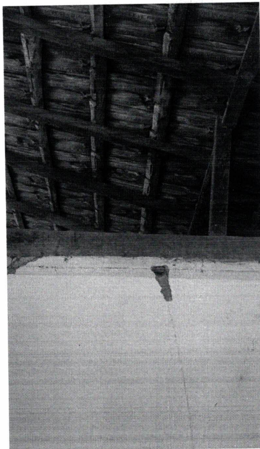
FOTO 19 – REBOCO E TELHADO DANIFICADO – EM 19/07/2022.
