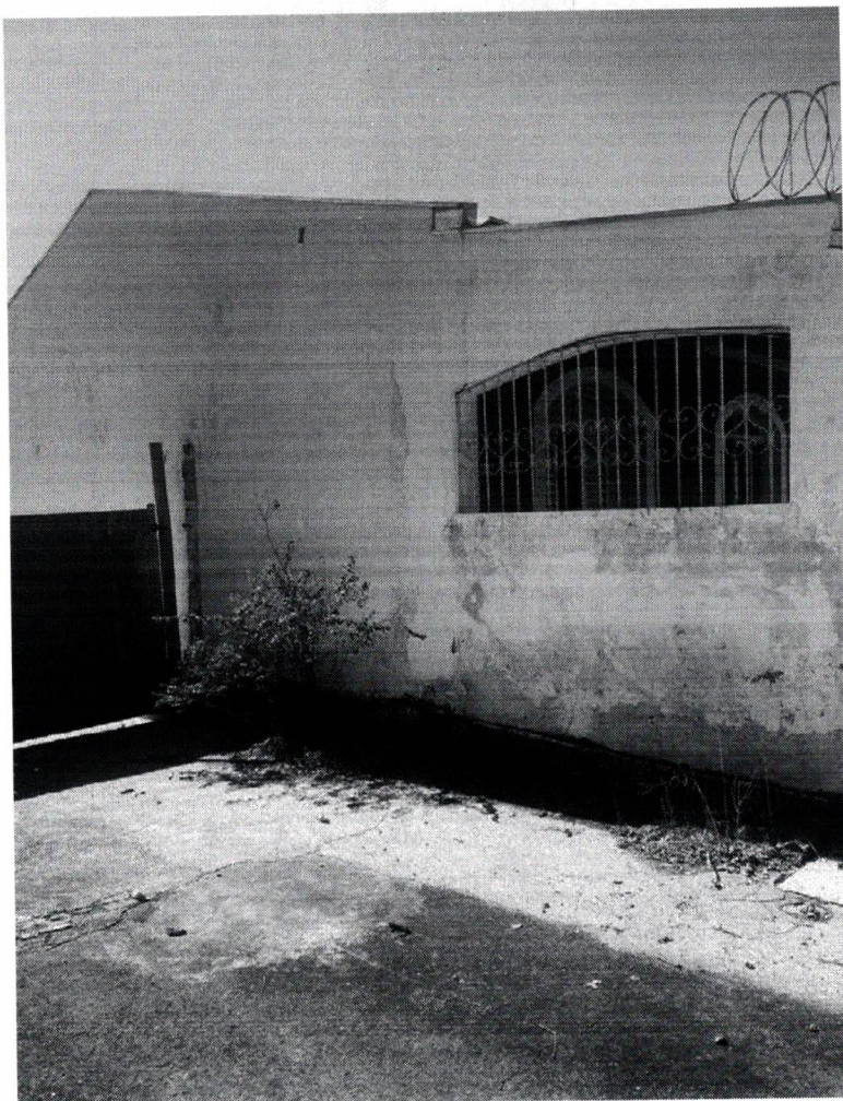
FOTO 11 – INFILTRAÇÕES NAS PAREDES – EM 19/07/2022.
